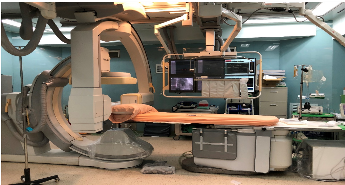
心導管室檢查台
